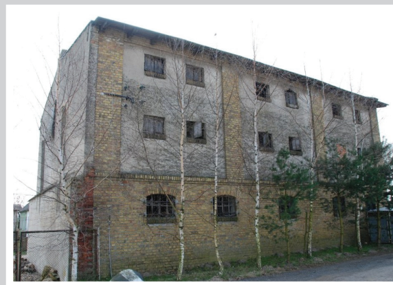
354. Spichlerz 3-kondygnacyjny w Mironowie, w obrębie podwórza pofolwarcznego z cegły ceramicznej. W zdemolowanej zabudowie dawnego zespołu folwarcznego (założonego w XIX w.) spichlerz jest jedynym obiektem o zachowanej pierwotnej formie architektonicznej (KEZ-A 799).
