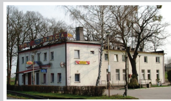
331. Zjazd przydrożny w Dębcu z początku XX w. z cegły z płaskimi dachami, po nieumiejętnej modernizacji na hotel został pozbawiony walorów zabytkowych, 2006 (KEZ-A 758) Pograża się w ruinę.
